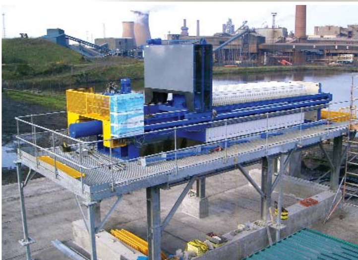
Filtro prensa reconstruido totalmente, con la adición de un lavador de telas tipo cabina y estructura de base nueva
